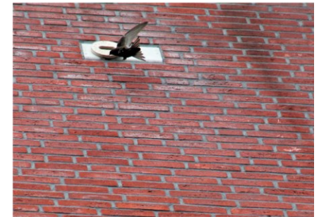
In gevel geïntegreerde nestgelegenheid voor gierzwaluw
